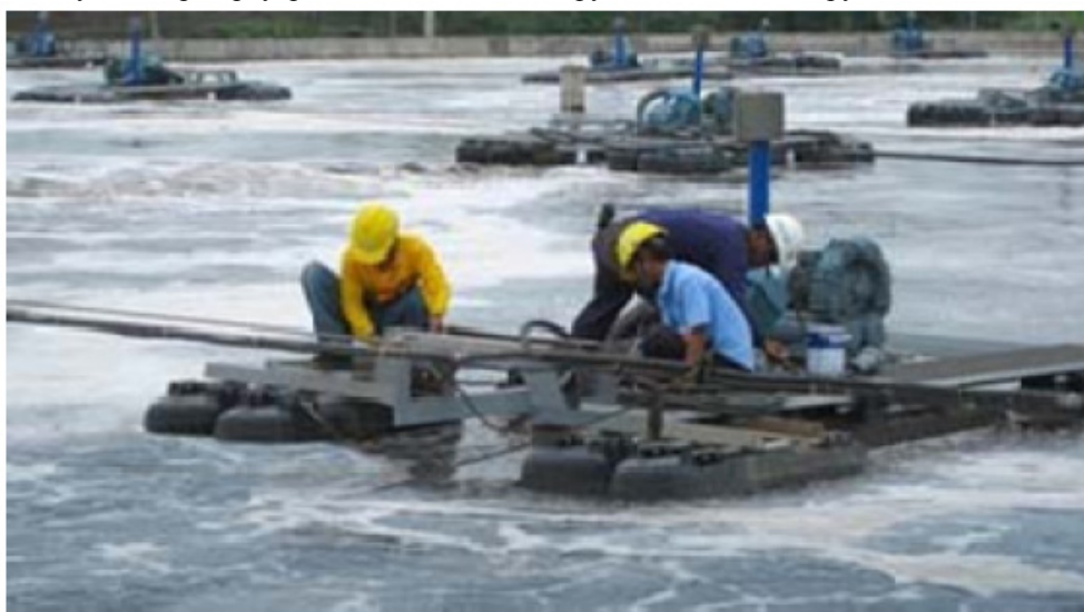
Рис.5 Рабочие производят плановый осмотр аэратора Triton, пока остальные аэраторы продолжают работать. Нет необходимости в спуске воды из резервуара или в грузоподъемных кранах
