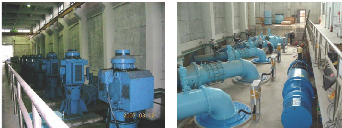
Рис. 4.2: Вид насосной станции Ta Tung (Тайвань) до и после замены полупогружных насосов на погружные с нижним всасом воды.
