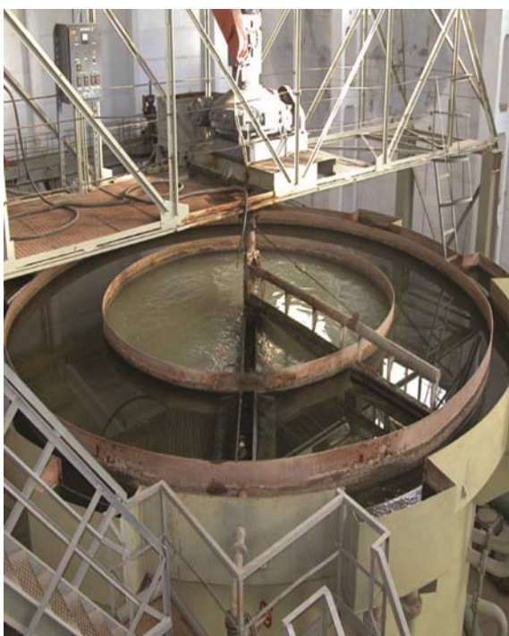
Рис.10. Екатеринбург, Уралмашзавод. Отстойник-флокулятор диаметром 9м., производительностью 350 м 3 /час на очистных сооружениях промливневого стока. При двухреагентной обработке остаточное содержание взвешенных веществ 6÷8 мг/л, нефтепродуктов 0,1÷0,3 мг/л (ПДК культ-быт ). После доочистки на песчаных фильтрах содержание загрязнений, соответственно, менее 1 мг/л и 0,01÷0,07 мг/л (в среднем - ПДК рыб-хоз ).
