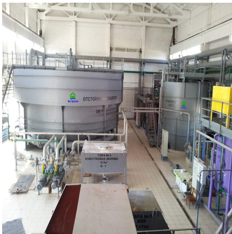
Рис.7. Башкортостан. Сибайский филиал Учалинского ГОКа. Одноступенчатые очистные сооружения шахтных и подотвальных вод. Отстойник-флокулятор диаметром 10 м. и сгуститель-флокулятор осадка диаметром 5 м. Производительность сооружений -400 м³/час.
